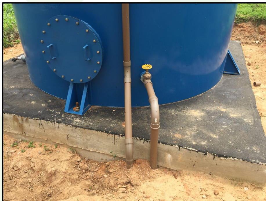
Figura 27 – Tubulação Ligada ao Reservatório R05
