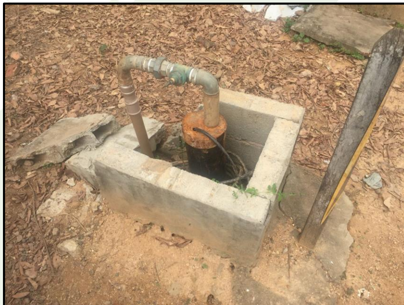
Figura 18 - Poço 02 em Funcionamento no Distrito de Três Fontes
