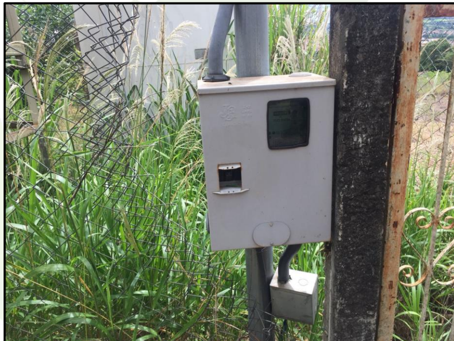
Figura 31 – Medidor do Reservatório R07
