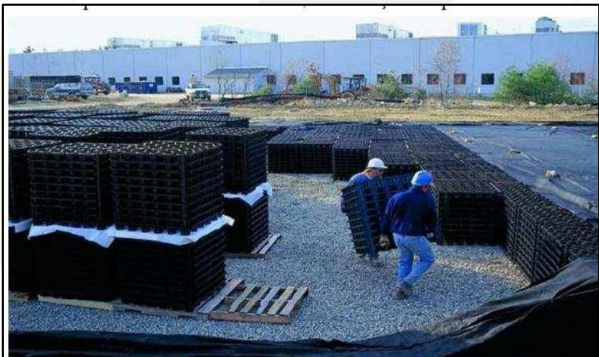
Figura 45 - Reservatório de detenção enterrado
