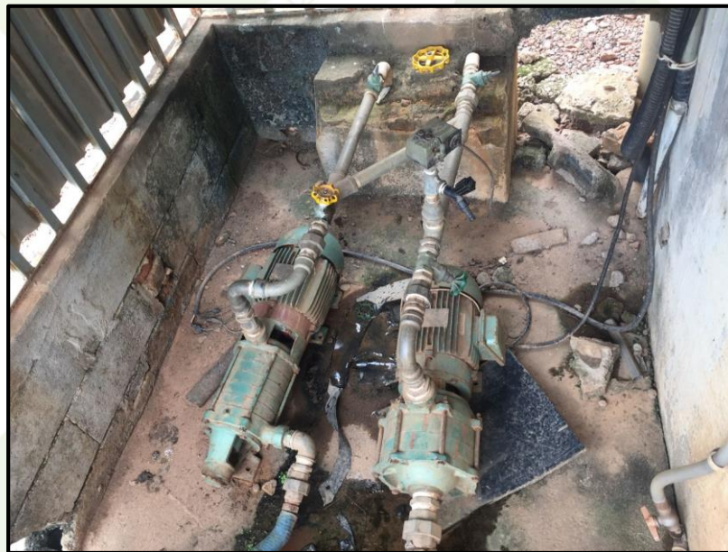
Figura 22 – Conjunto de Bombas no Reservatório R02
