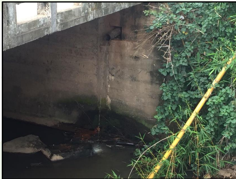
Figura 35 - Ponto de Lançamento de Esgoto Sanitário no Rio Palmeiras
